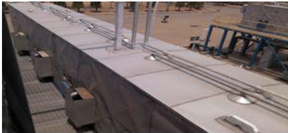
Gambar 2. Flash Evaporator PLTGU Gresik (sumber ; PT PJB UP Gresik, 2014)
