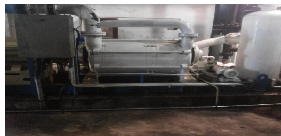
Gambar 2. Pompa Vakum PLTU Lontar Banten.
